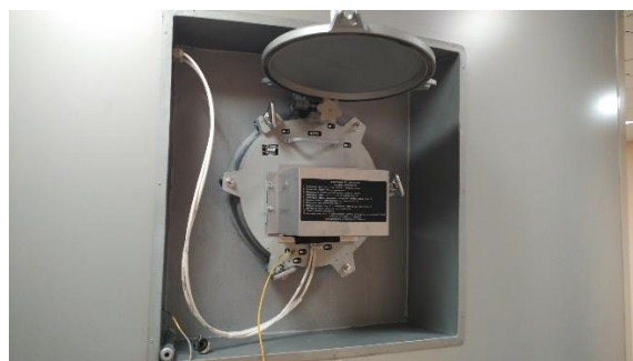
Камера и коммуникационное оборудование закрепленное на иллюминаторе
